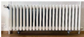
Radiator (Holz- Öl- oder Gaszentralheizung)
