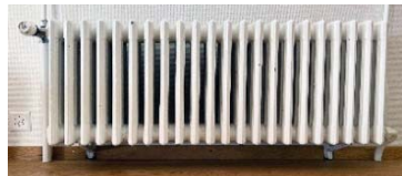
Radiator (Holz- Öl- oder Gaszentralheizung)
